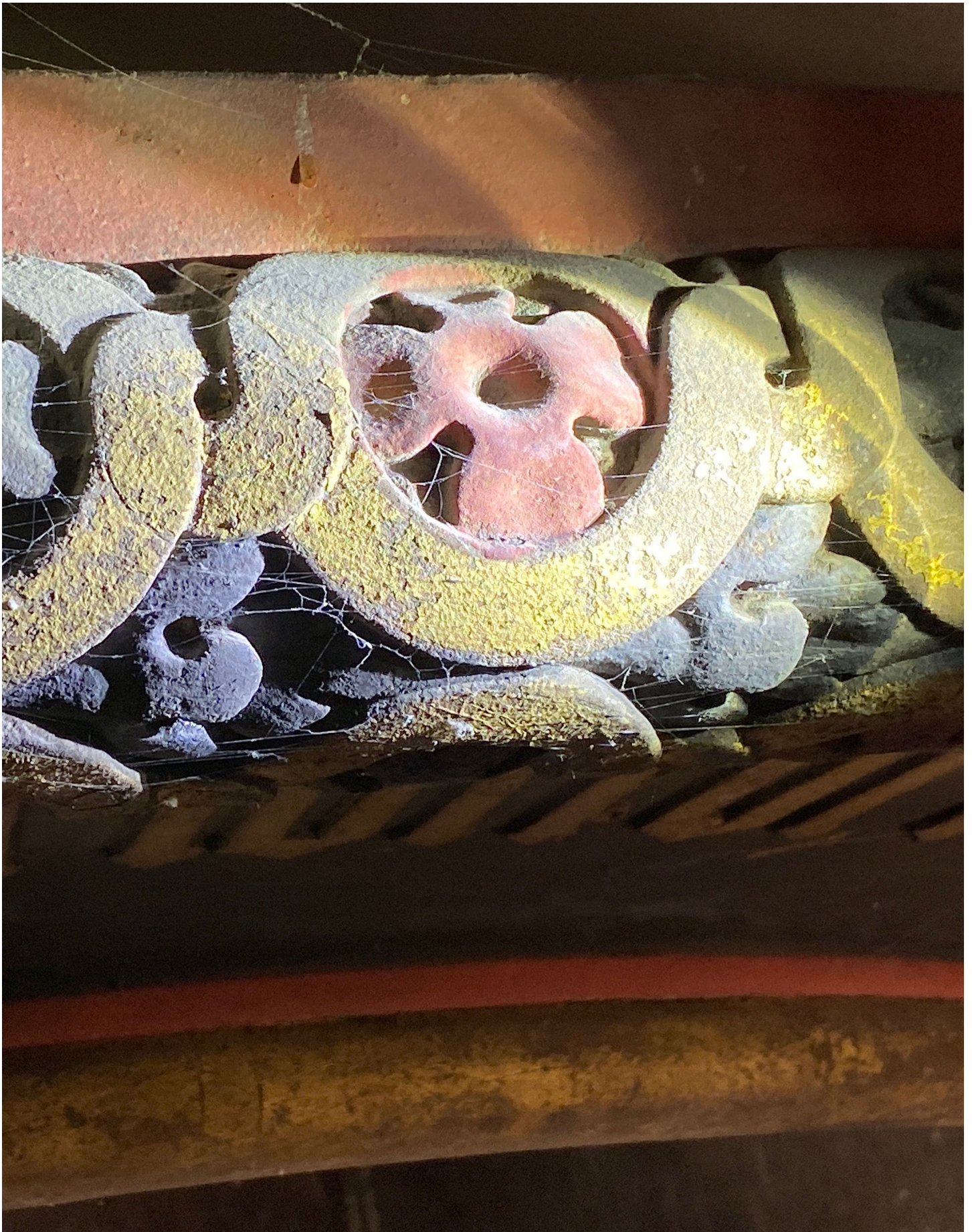
05: Detailaufnahme Schäden Metallauflagen und Polychromie am grossen Sprengring. Zustand 2020. Foto: Dipl. Restauratorin Cornelia Marinowitz, Tengen (D).
