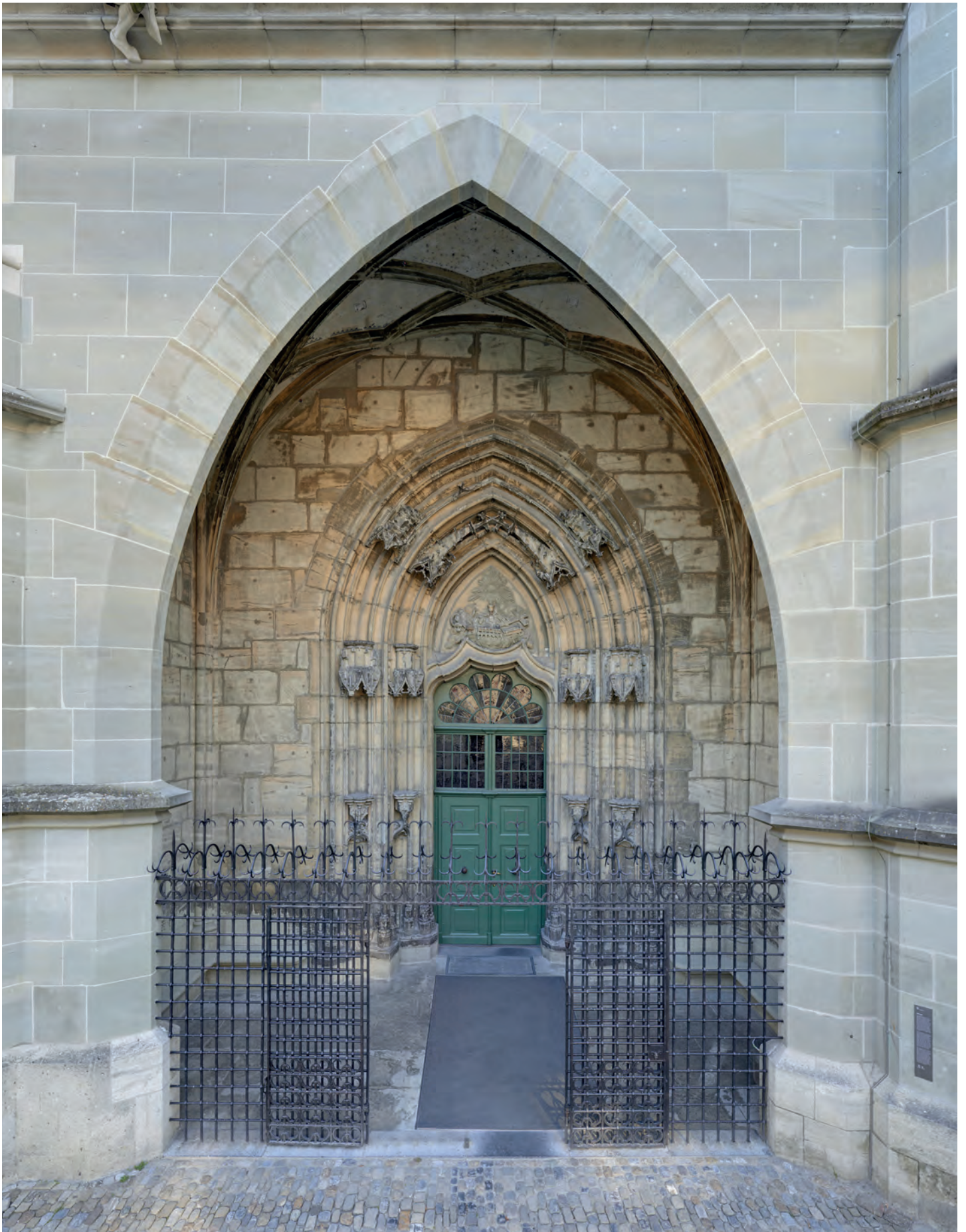
01: Foto Westportal Nord, Vorzustand 2015. Die stark verdunkelten Zementfugen der Fugenrenovatio- on von 1899 dominieren und stören das Gesamtbild empfindlich. Foto: Nick Brändli, Zürich
