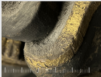
Zustand vor der Reinigung, Staubauf-lagen an einem Wappenstein.
