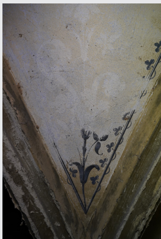
Verlust von Kapfenbmalungen auf den 1899 neu verputzten Gewölbekappen.
