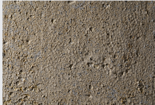
Exakt gleicher Bereich nach der Festigung, Makroaufnahme im Streiflicht.
