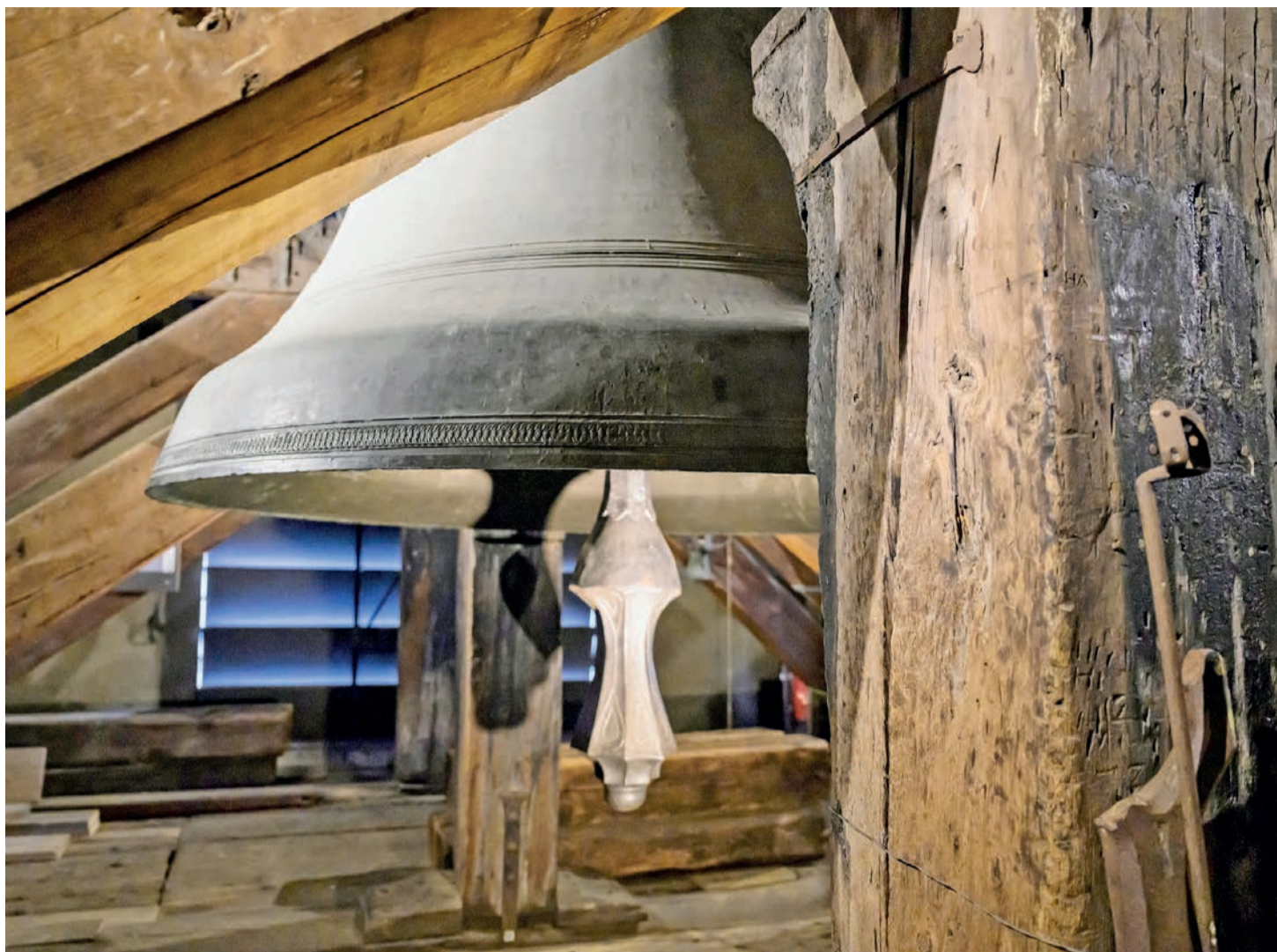
Im Münsterturm sind die Glocken von Holz umgeben. Ihre elektrische Steuerung soll deshalb so sicher wie möglich sein.
