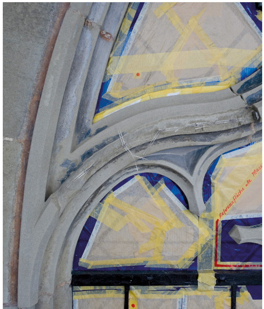
Bild 11 Ein Teil der Profile ist bereits mit Mörtel ergänzt, in der Bildmitte erkennt man die Armierung, hier bestehend aus 2 mm V4A-Gewindestangen und Glasfaserstreifen.
