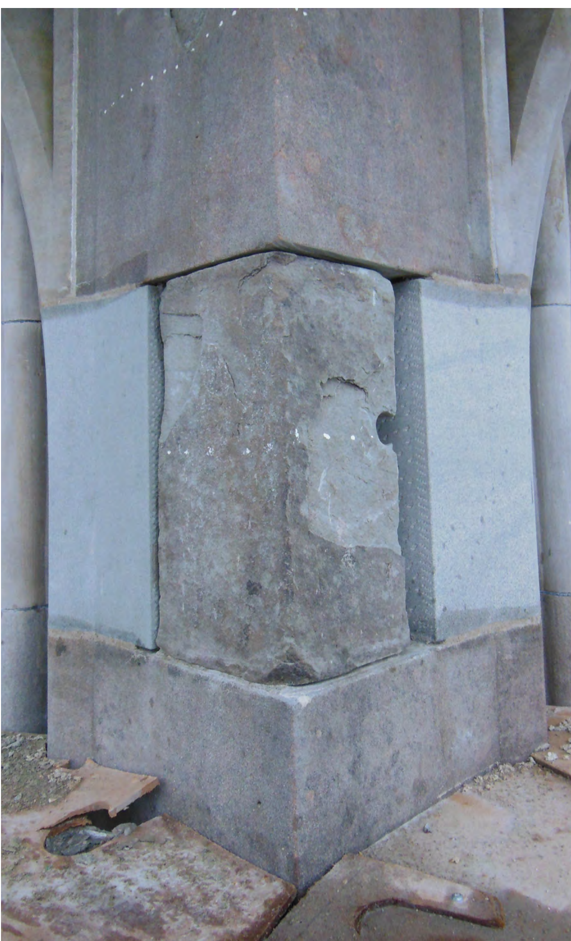
Stark verwitterter Stein am Turmhelm.
