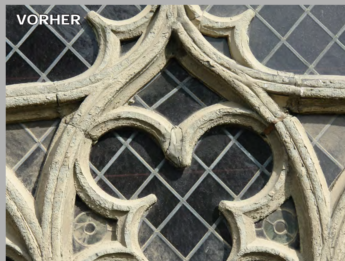
Seitenschiff Feld 50 Südseite - Masswerk mit starken Verwitterungsschäden.
