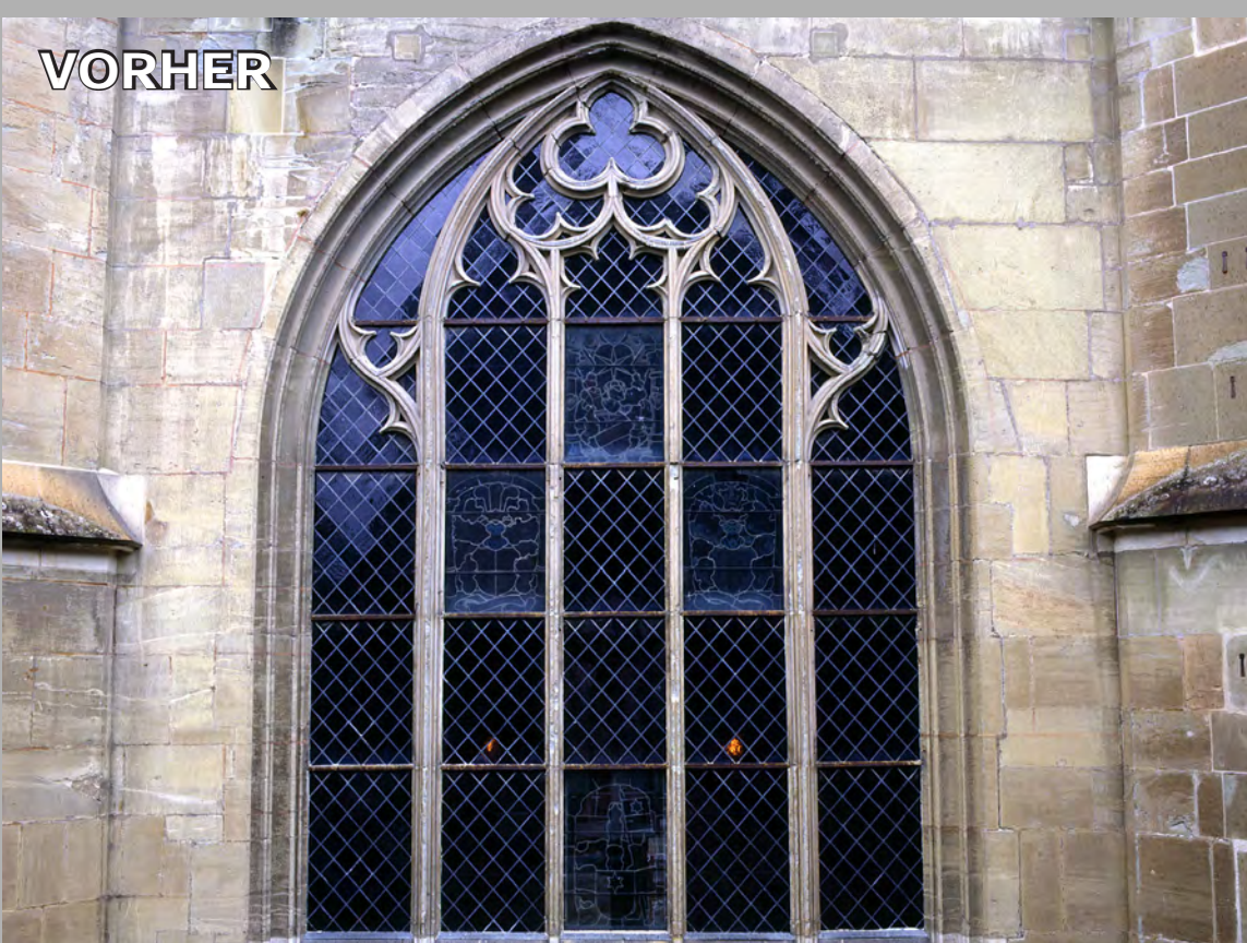
Seitenschiff Feld 70 Süd vor der Konservierung / Restaurierung.
