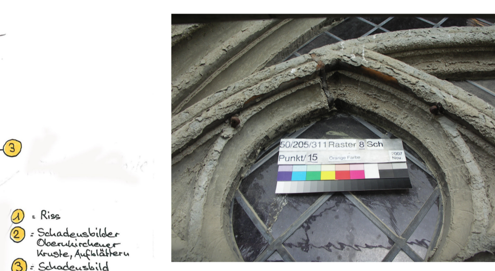
Detail 15: Orange Farbreste auf der Rundstaboberfläche des Masswerks.
