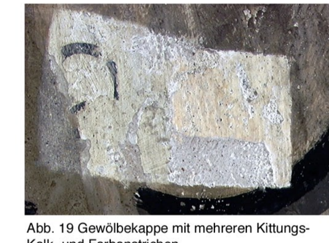
Abb. 19 Gewölbekappe mit mehreren Kittungs-Kalk- und Farbanstrichen
