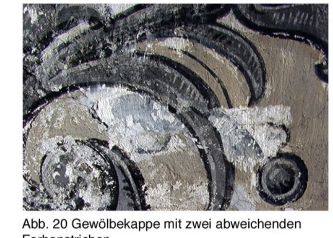
Abb. 20 Gewölbekappe mit zwei abweichenden Farbanstrichen
