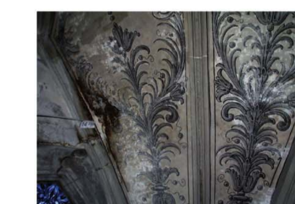
Schaden am Seitenschiffgewölbe hervorgerufen durch undichte Galerien.
