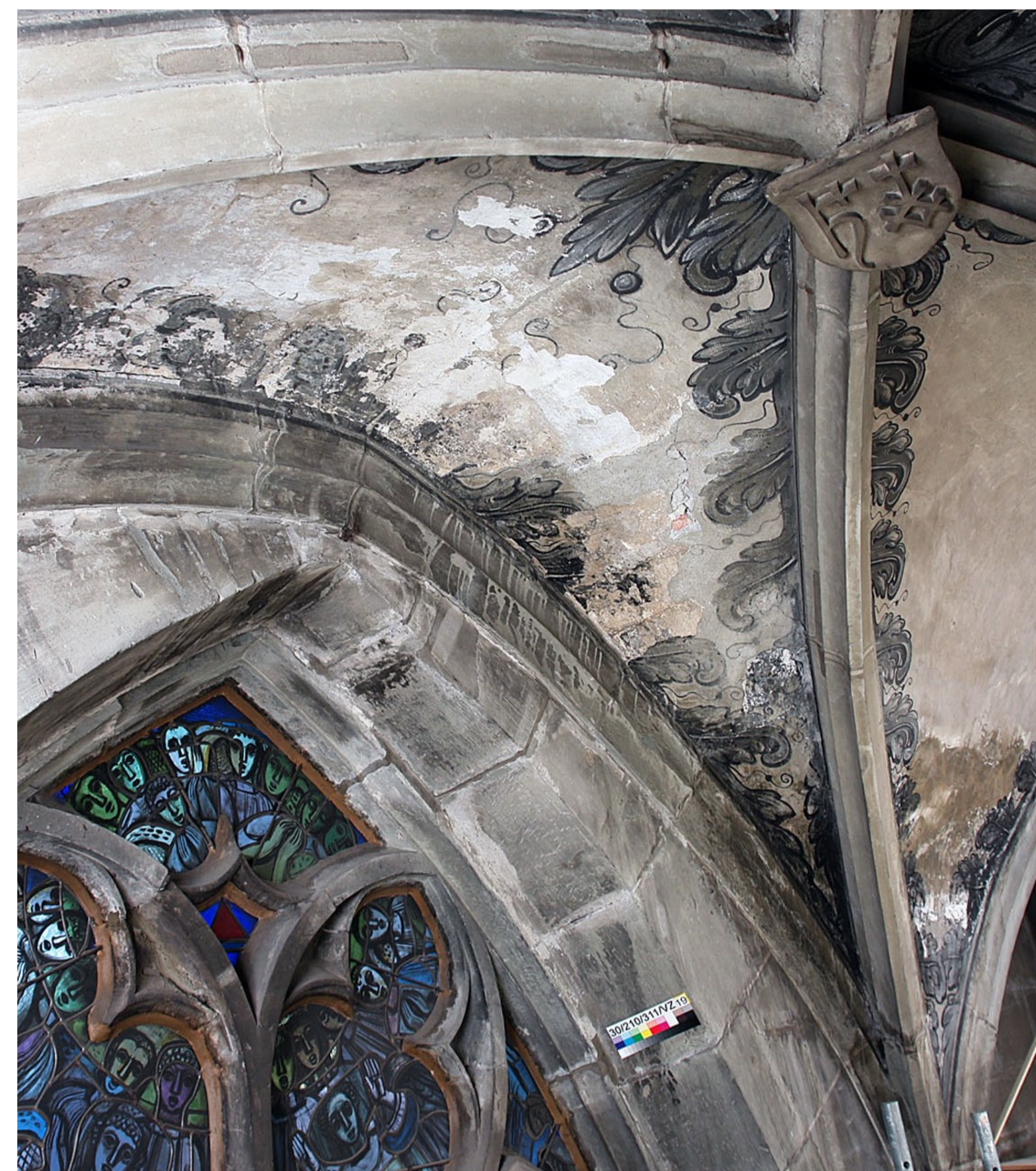
Schäden am Gewölbe der Schutzkapelle verursacht durch jahrelange Wassereinträge über die Seitenschiffgalerien. Nach der Auskleidung der Galerien mit Bleiblech konnte die Restaurierung des Innenraumes in Angriff genommen werden.
