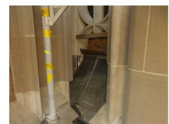
Auskleidungen und Wasserabweisbleche reduzieren Schäden an den darunterliegenden Bauteilen.
