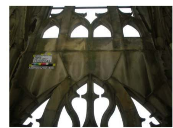
Wasserschäden im Turmhelm.
