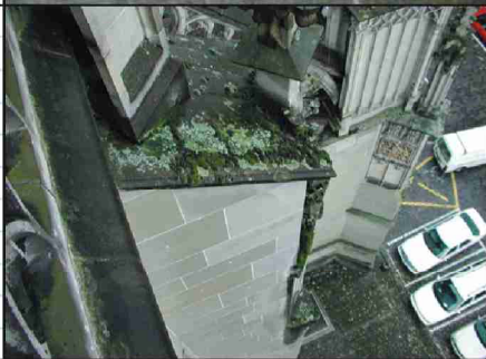
Organischer Bewuchs Aufrauung der Steinoberfläche durch Flechten und Moose. So wird der Stein verwundbar für andere Umwelteinflüsse. Der Stein bleibt ständig feucht, was zu Auswaschungen und Salzschäden führt (Diverse Mikroorganismen bilden Schwefelsäure).
