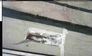
Folgen von sich durch Rost ausdehnenden Eisenteilen Grosse Kreuzblume auf 95 m über Boden (feiner Steinriss durch angerosteten Flacheisendorn von ca. 1946), Gewölberippen innen (Steinsprengung durch angerosteter Eisendübel von ca. 1912).
