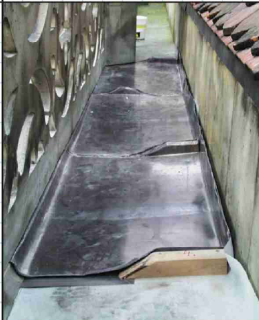
Schützen Abdichtung Galerien mittels Bleiabdeckungen, wie seit über 100 Jahren am Kölner Dom erprobt
