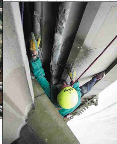
Sichern der Publikumsbereiche Entfernen loser Stücke hoch über der Besuchergalerie am Turm
