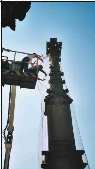
Schnelle Erste Hilfe Sicherheitsnetz + Stahlkorsett an Südlicher Fiale Westwerk
