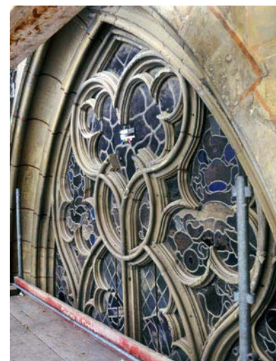
oben: Vorzustand Fenstermasswerk
