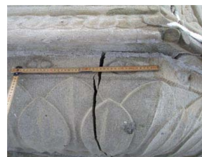
Riss in der Konsole Zustand vom 10.02.2004
