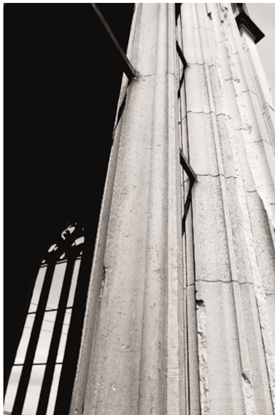
Die Fassade des Münsterturms bröckelt, nun wird sie bis im Jahr 2015 renoviert. VALÉRIE CHÉLAT
