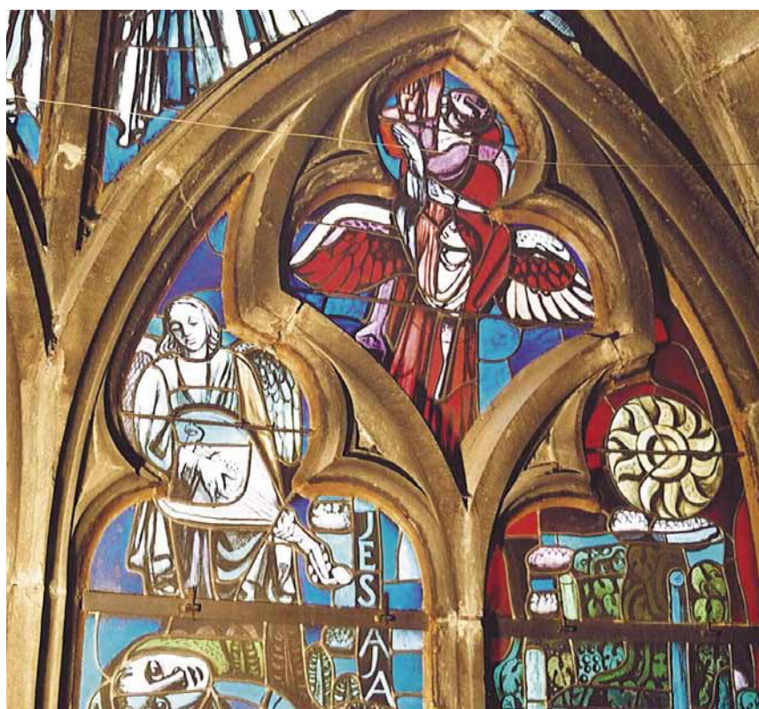
oben: Ein Mitarbeiter des Ateliers für Glasmalkunst M. Halter beim Erneuern einer Kittfugen an der Innenseite / unten links: Ausschnitt aus dem Jesaiafensters vor der Restaurierung 2007 / unten rechts: Ausschnitt der neuen Schutzgitter auf der Aussenseite
