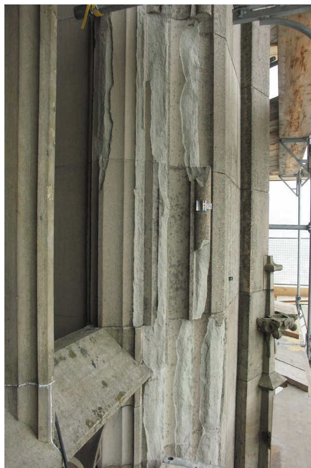
Schäden im Fenstergewände, oberes Achteck Nordwest
