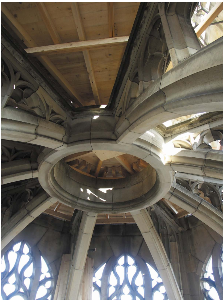
Ansicht des Notdaches über dem Turmwachtgeschoss von unten. Das Notdach wird das weiter unten liegende Gewölbe des Haspelbodens bis auf weiteres vor Wassereintrüben schützen
