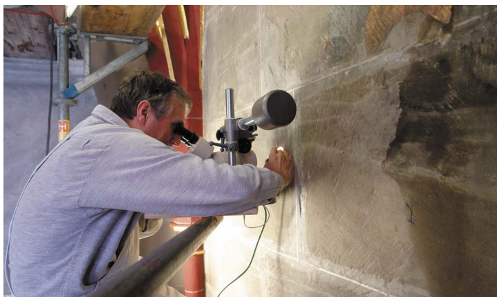
Freilegen der Wandmalerei
