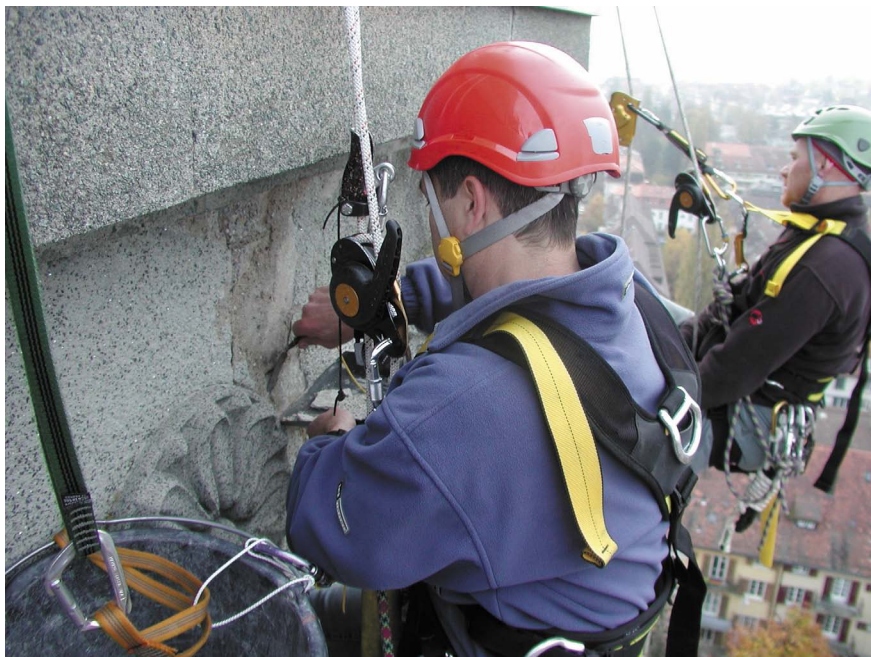
Abnehmen loser Putzteile
