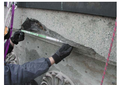
Abnehmen von gerissenen Teilen
