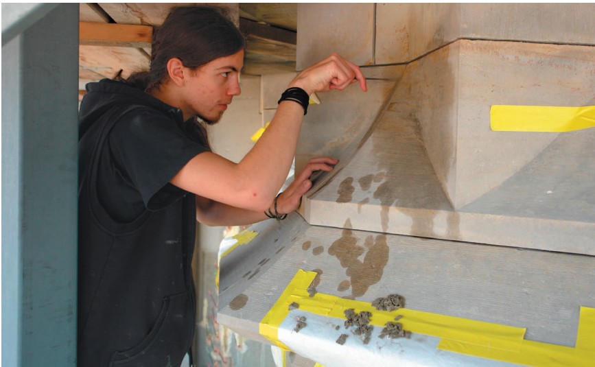
Die Fugen der Fialen des oberen Achtecks waren beim Bau in den 1890er Jahren mit einem sehr harten Zementmörtel geschlossen worden. Diese Fugen waren zu ca. 80% stark beschädigt. Der Fugenverschlussmörtel war abgerissen und teilweise herausgefallen. Das Schliessen dieser Fugen verursachte einen grossen Teil des Arbeitsaufwandes.
