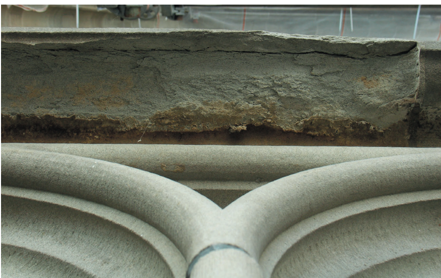
oben: Schadensbild bei den Masswerkbrücken (Fensterbänken) am Christusfenster. Die Bauteile weisen starke Rissbildungen und vor allem auf der Unterseite sehr instabile Oberflächen auf.
