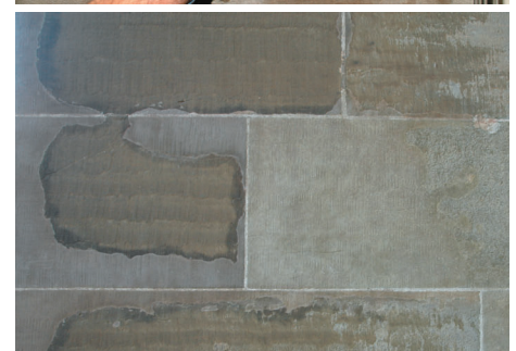
Einige der in den ersten Jahren (2001-2003) erfolgten Retuschen zeigen an den Mörtelrändern am Übergang zum Stein dunkle Verfärbungen. Diese rein ästhetischen Mängel wurden mittels neuer Retuschen behoben.
