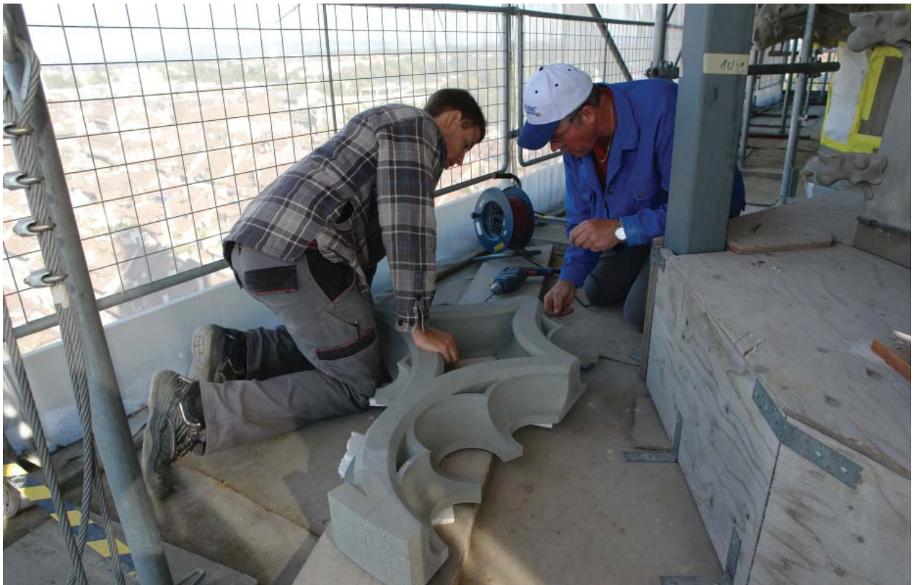
(o.) Anlieferung des neu gefertigten Masswerkstücks auf die Gerüstbasis. Bohren der Dübellöcher.
