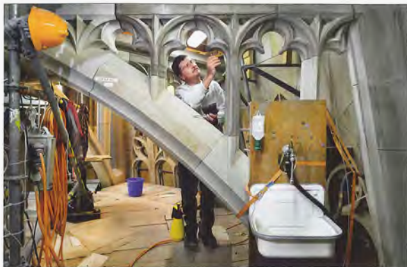
Steinmetz Ulrich Aeschbacher repariert mit Mörtel aus authentischen Materialien abgegrübelte Ecken und Kanten im Strebewerk
