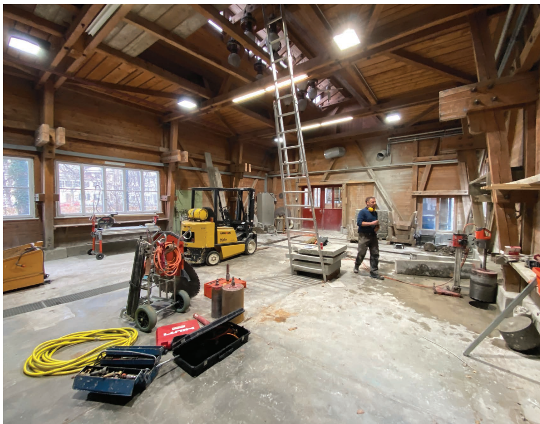
Münsterbauhütte: Sägehalle, nach dem Ausbau der alten Gattersäge. Damit wurde Raum frei für an heutige Herausforderungen angepasste Arbeitsplätze.
