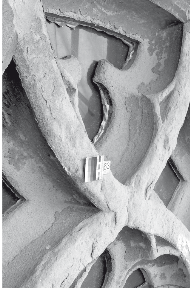
Abb. 1: Schadensbilder an einem Maßwerk aus Gurten-sandstein. Unteres Achteck, um 1520
