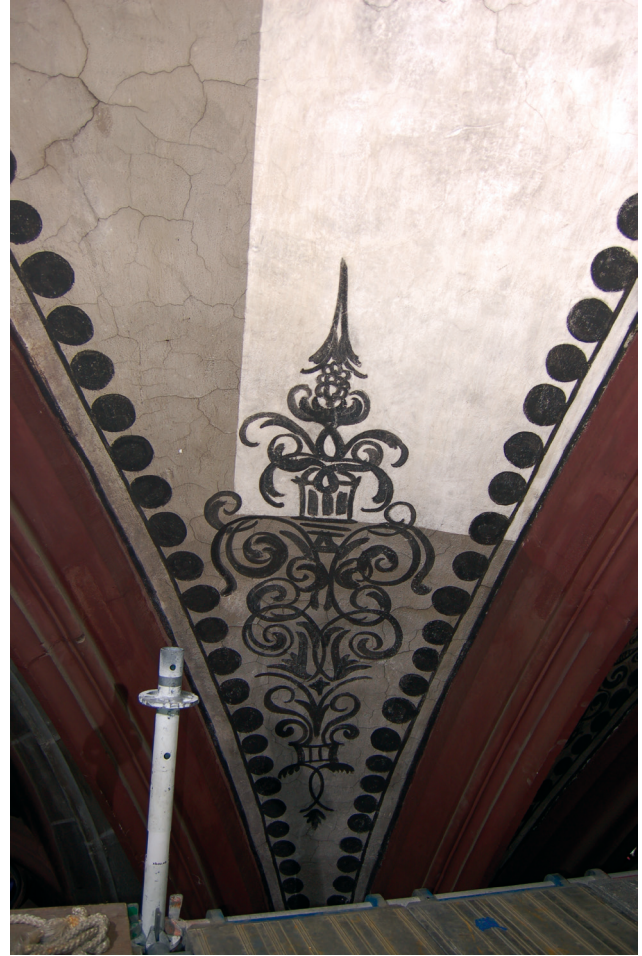
Abb. 26: Gewölbekappe Chor: Zustand mit Reinigungsmuster (Foto: Cornelia Marinowitz)
