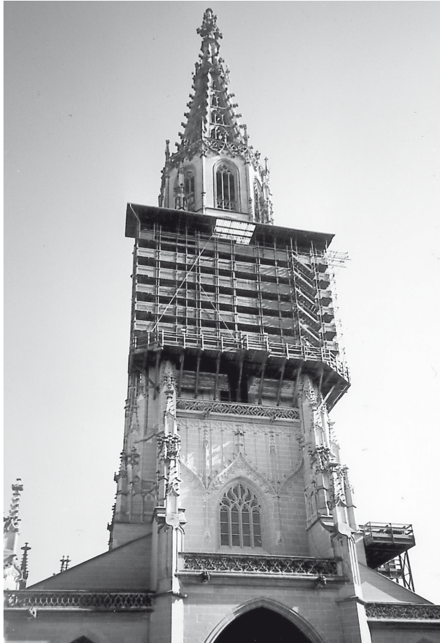
Abb. 5: Letzte umfangreiche Renovationsetappe: Oberes Turmviereck West, Steinaustausch 100%. Standzeit des Gerüsts an diesem Fassadenabschnitt: 1982–2002
