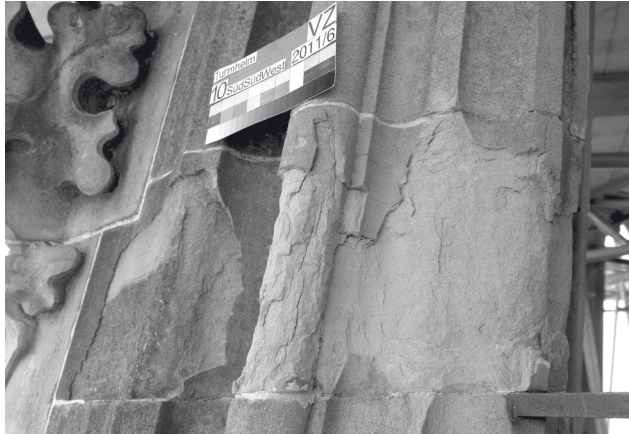
Abb. 2: Stark geschädigte Turmhelmstrebe aus Zuger Sandstein aus der Zeit der Turmaufstockung um 1890.
