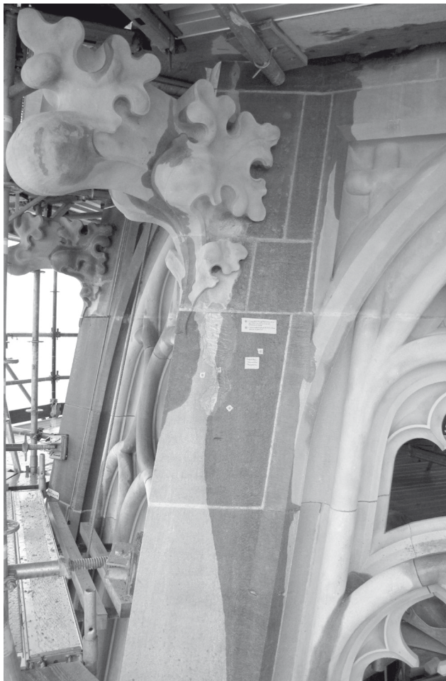
Abb. 3: Nach einem starken Regenfall bleibt der Bereich unter der Krabbe aus Oberkirchener Sandstein zunächst trocken. Genau in diesem Bereich zeigen sich im Zuger Sandstein die stärksten Schäden, meist Schalenbildungen und oberflächliche Verwitterungsbilder.
