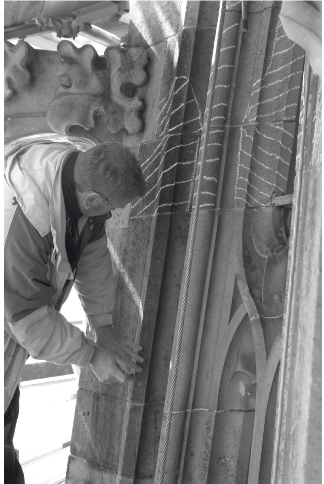
Abb. 7: Detektion von Schalen mit dem Bleiklopfer. Die mit weißer Kreide markierten Bereiche lassen sich bei der Reinigung der Oberfläche mühelos wieder entfernen.
