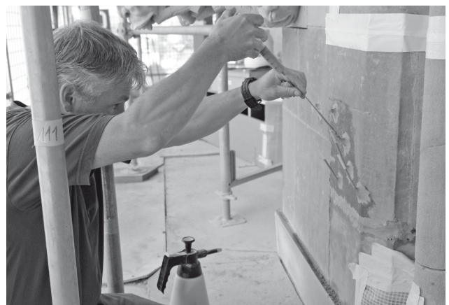
Abb. 12: Inzwischen werden die Injektionen meist über Trinkhalme, befestigt mit Ton, durchgeführt. Eine einfache aber sehr effektive Methode wenn ohne Druck verfüllt wird.
