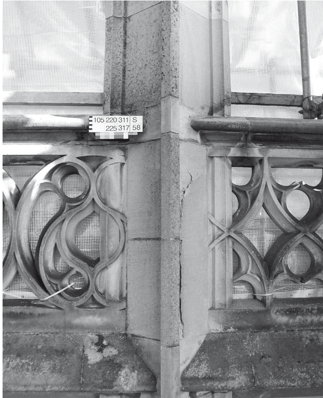
Abb. 16 „Baumangel“: Die Schaftstücke der Brüstungsfiale über dem Chor (Zuger Sandstein) wiesen im Verbund mit den umgebenden Brüstungsmaßwerken aus Oberkirchener Sandstein starke Risse auf.
