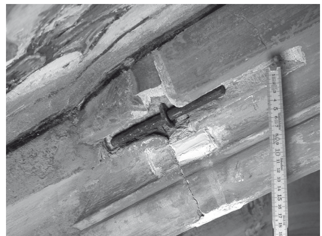
Abb. 4: Freilegung der rostenden Dübel und Ersatz derselben durch Dübel aus Edelstahl wo sinnvoll und notwendig
