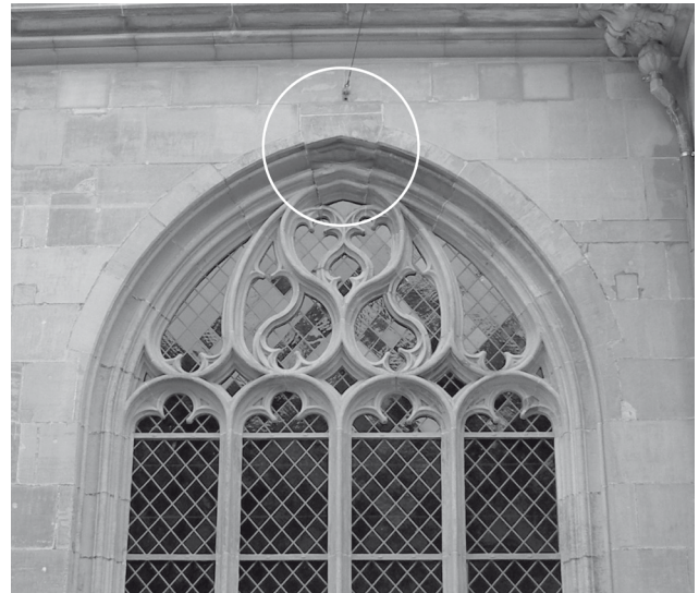
Abb. 13: Zeitzeugnis: Der sichtlich bereits früh verrutschte Schlussstein beim Fenster 90 am nördlichen Seitenschiff wurde nicht gerichtet, sondern in situ restauriert (Münsterbauhütte 2004)
